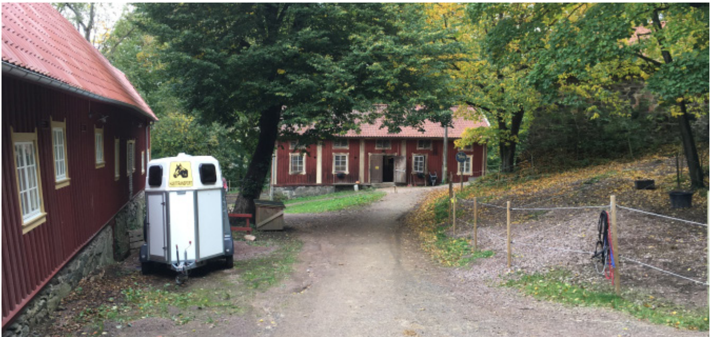
Stallbyggnad i dåligt skick
