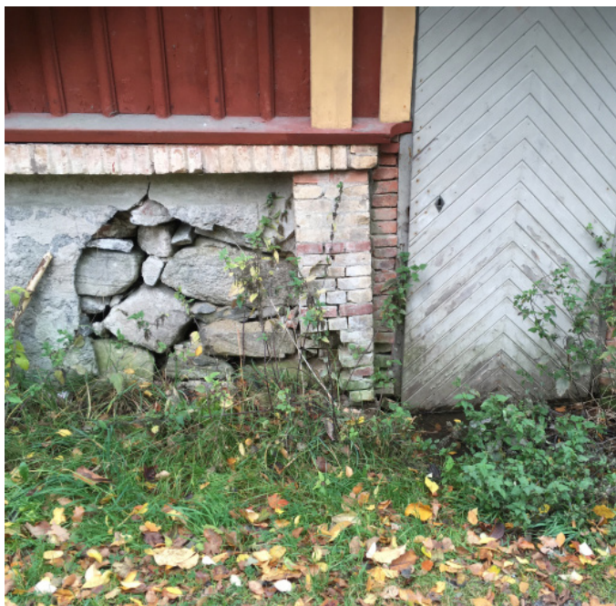
Jordkällaren. Skador i sockelmur
